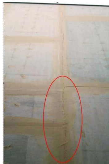
FIGURA 3: FISSURAS EM PLACAS FONTE: TESTOLINO ET AL. (2009)
