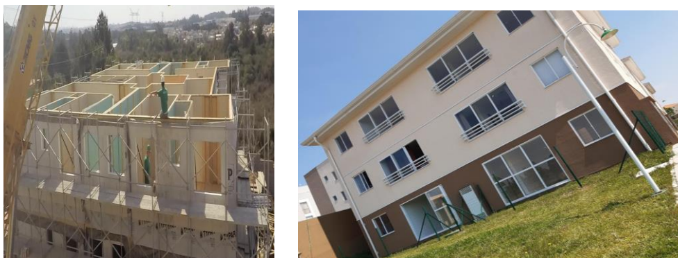
FIGURAS 4 E 5: SISTEMA CONSTRUTIVO WOOD FRAME EM EXECUÇÃO PELA TEC VERDE, EM ARAUCÁRIA, E OBRA FINALIZADA, RESPECTIVAMENTE. FONTE: TEC VERDE (2019) E OS AUTORES (2019).
