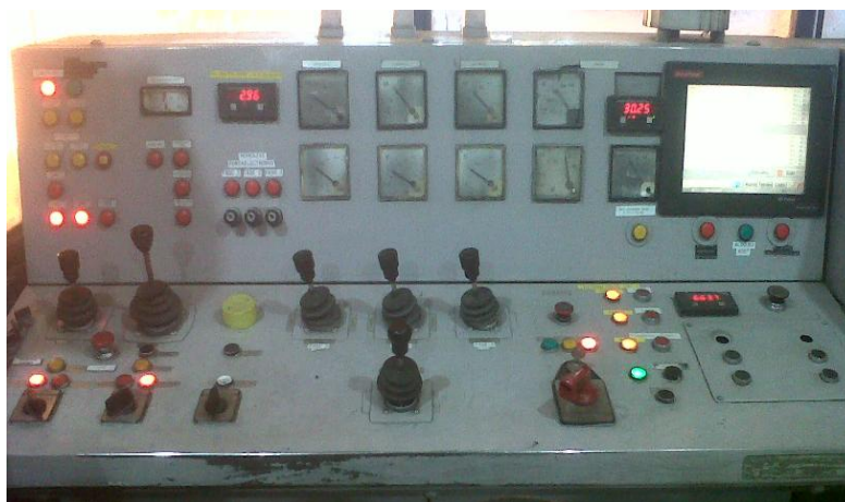
FIGURA 2 - PAINEL INDICAÇÃO E OPERAÇÃO DO FEA FONTE: GERDAU (2013)
