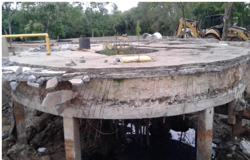
FIGURA 2: Registro fotográfico após colapso da laje superior do RALF 01 da Estação de Tratamento de esgoto da cidade de LAPA – PR. FONTE: Os autores (2018).
