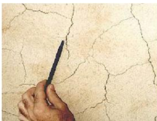
FIGURA 2: FISSURAS MAPEADAS EM FACHADA FONTE: FREITAS, FRANÇA E FRANÇA (2011)
